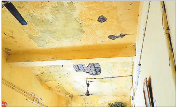
भवन के छत का उखड़ा प्लास्टर।
